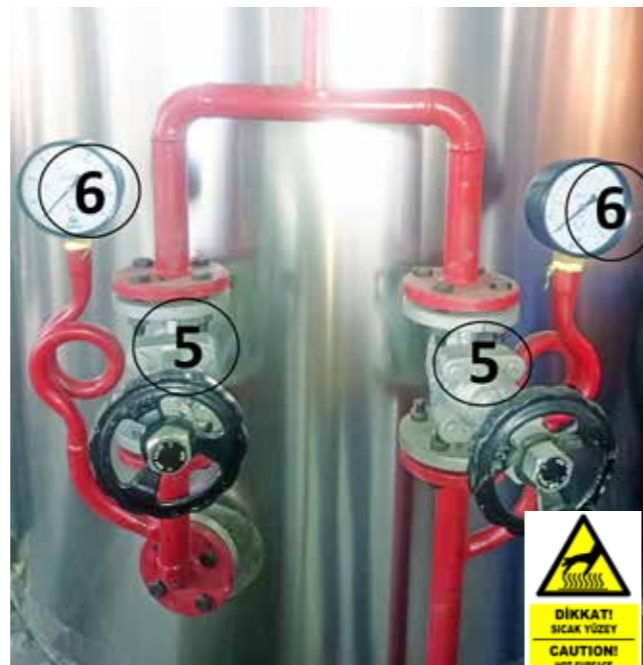
5. Входящите вентили с 5 блока се отварят и устройството се нагрява.
