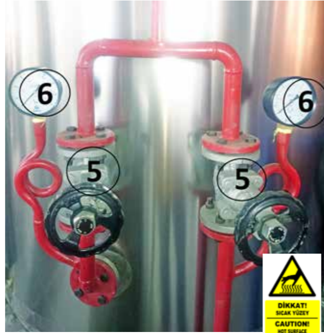
5. Ünite giriş vanaları açılarak ünitenin ısıtılması sağlanır. 6. Buhar giriş basıncı gözetlenir.
