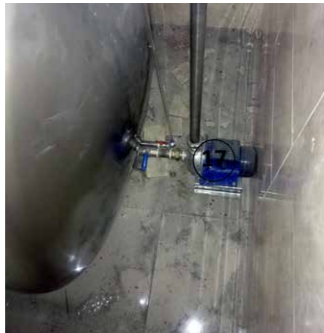
16. Натрупаната вода в резервоара се изпомпва в резервоара за масло с помпата.
